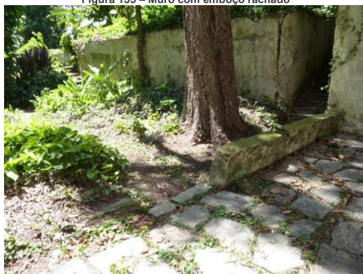
Figura 135 – Muro com emboço rachado
