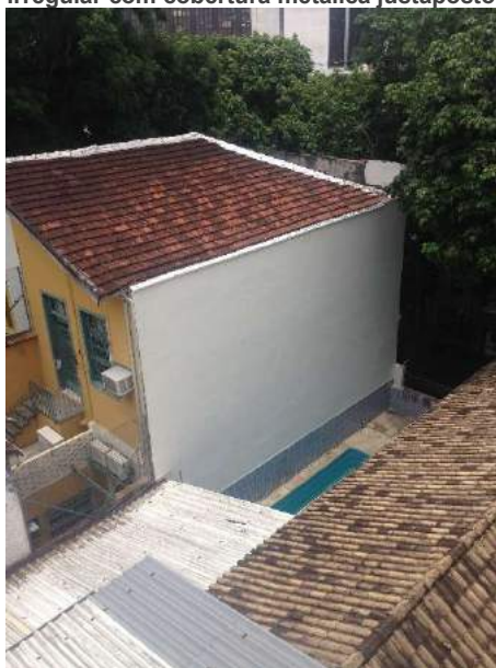
Figura 36: Acréscimo irregular com cobertura metálica justaposto ao prédio preservado.
