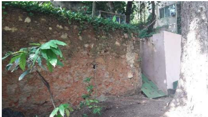
Figura 136 – Muro com emboço removido
