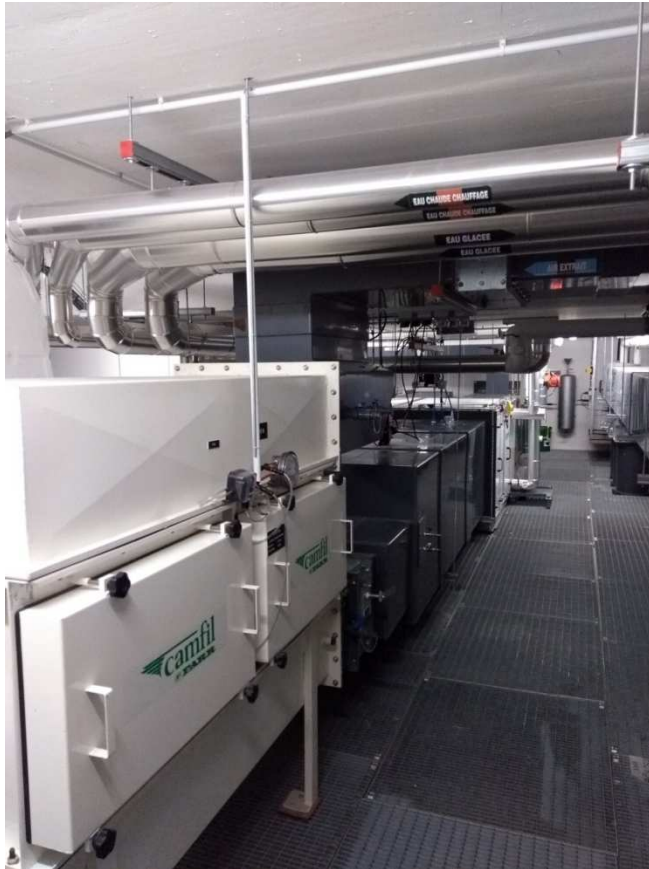
Imagem 32: Shafts e pavimentos técnicos – espaços exclusivos para equipamentos e sistemas. Edifício François Jacob, Instituto Pasteur, Paris, França. Fonte: Acervo do autor (2018).
