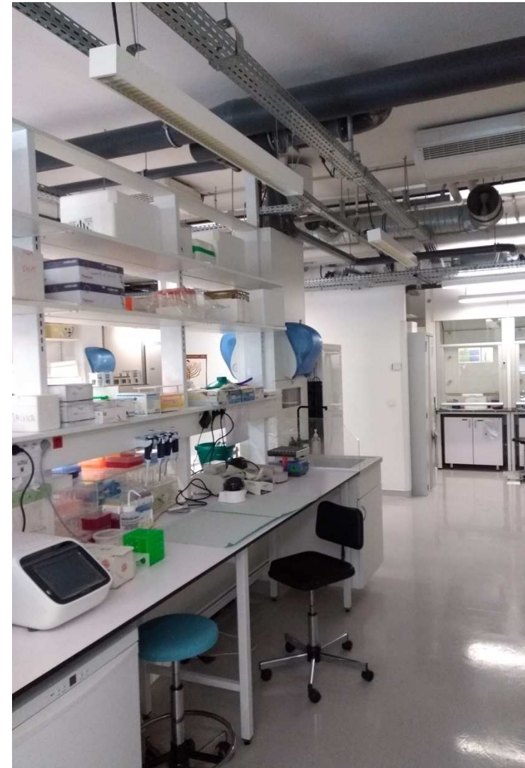
Imagem 31: Laboratórios com tubulações aparentes – sistemas independentes e visíveis. Edifício François Jacob, Instituto Pasteur, Paris, França. Fonte: acervo do autor (2018).
