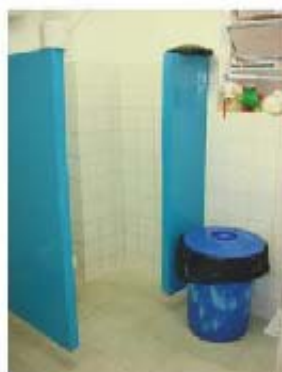
Foto 01: Box da bacia sanitária
