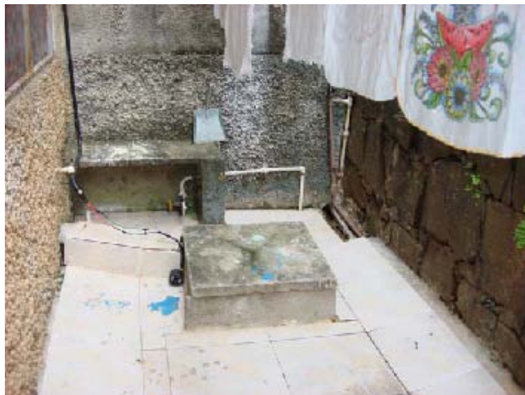
Foto 7: Cisterna localizada na circulação externa.
