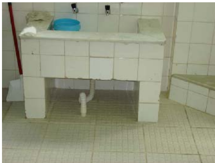
Foto 6: Azulejos quebrados no tanque do banheiro
