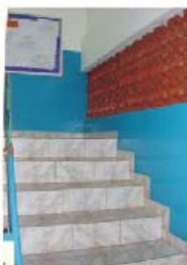
Foto 01: Ventilação por cobogós
