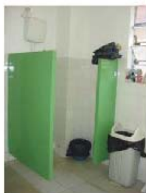
Foto 01: Box da bacia sanitária
