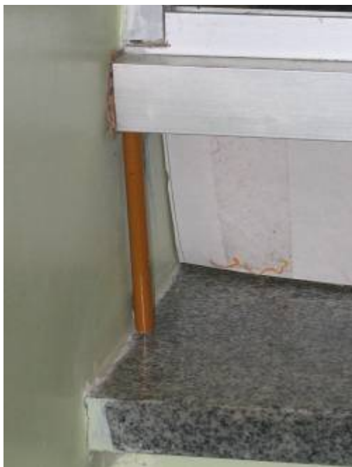
Foto 1 - improvisação do ar condicionado na secretaria
