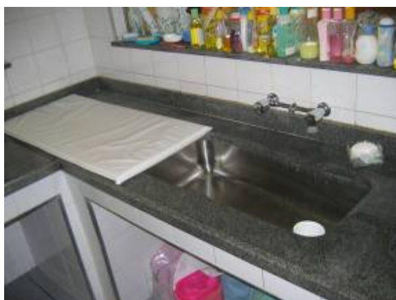
Foto 3 – ducha do fraldário danificada
