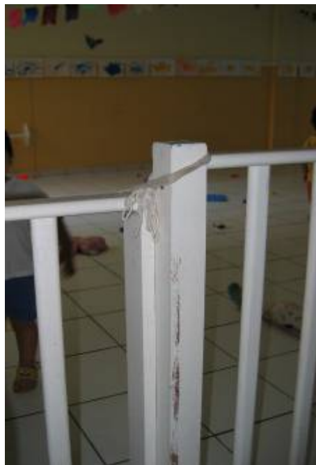
Foto 2 – Trinco da cerca quebrado (berçário 2)
