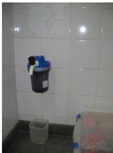
Foto 4 – filtro do lactário danificado
