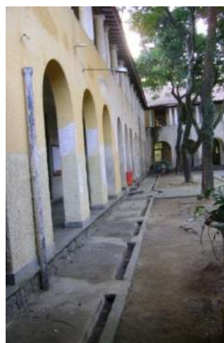
Figura 34: drenagem problemática. Fonte: GAE. 2010.
