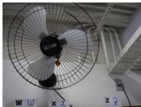
Fig. 107 – Ventiladores nas salas de aulas.
