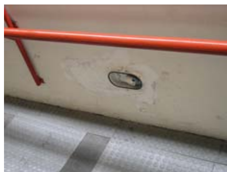
Fig. 75 – Falta de lâmpadas e luminárias na rampa.
