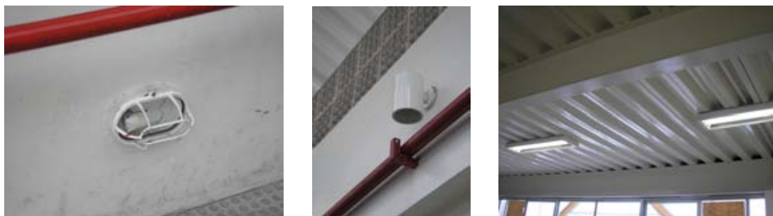
Fig. 109 – Detalhe das luminárias existentes na escola.
