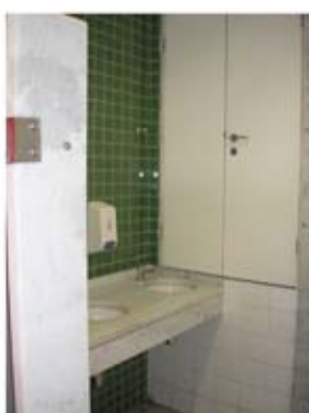
Figura 62-Foto do detalhe Lavatório Sanitário Infantil.
