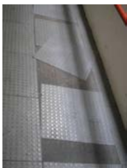
Fig.71 - Pisos soltos na rampa.
