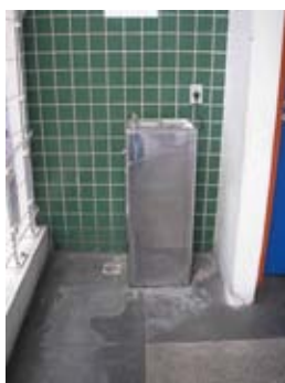
Fig.72 – Bebedouro sem Funcionamento
