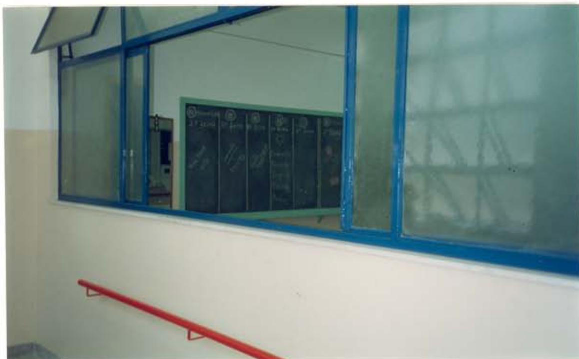
Figura IV.74 - Detalhe das aberturas (somente entrada de ar) - sala de aula (Foto da autora, novembro/1994)
