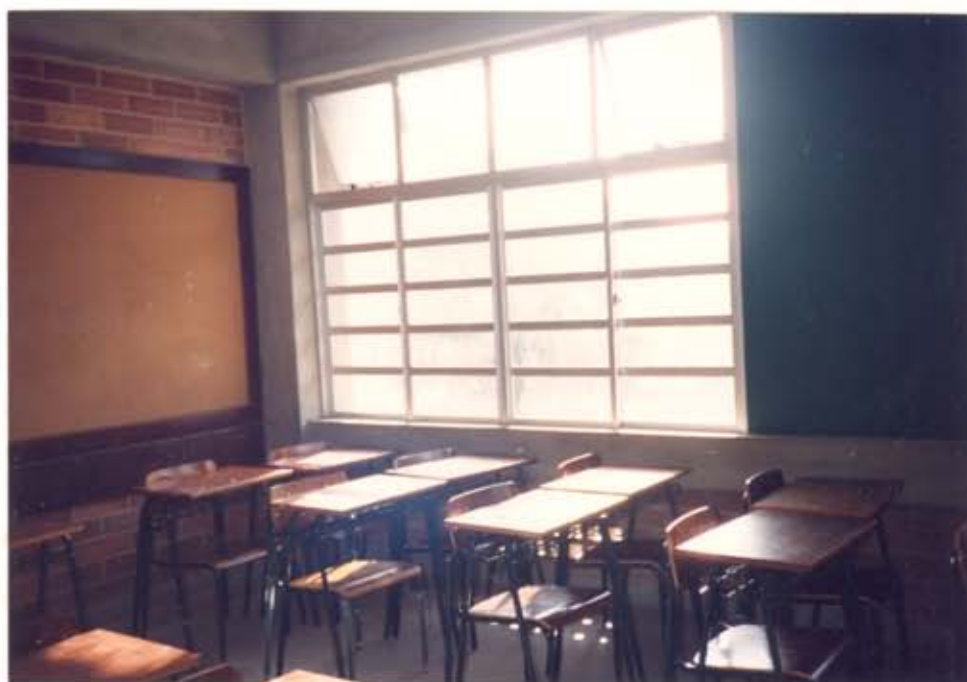
Figura IV.63 - Insolação das salas de aula, através das superfícies envidraçadas (Foto da autora, abril/1994)
