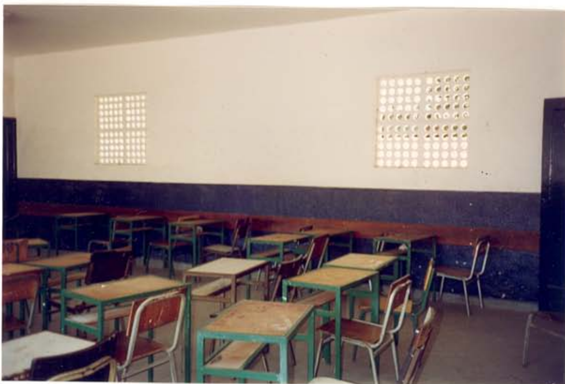
Figura IV.28 - Detalhe dos combogós - interior da sala de aula (Foto da autora, novembro/1994)
