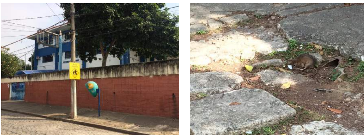
Figuras 58 e 59 - Muro de fechamento da escola e estado de precariedade da calçada - presença de roedores. Fonte: Sbarra, 2016.
