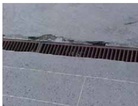
Figura 99 – Estado de conservação do ralo
