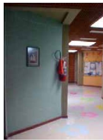
Figura 68 – Detalhe do extintor de incêndio
