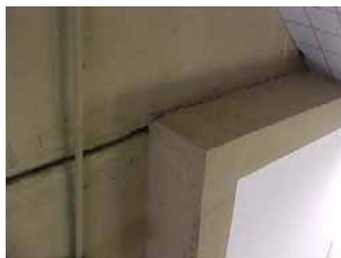
Figura 85 – Detalhe de manchas no teto
