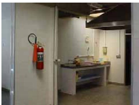
Figura 94 – Detalhe do extintor de incêndio
