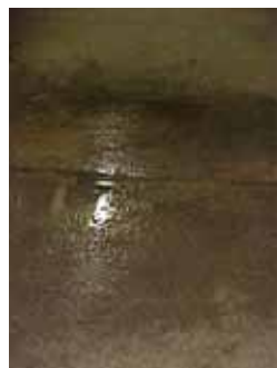
Figura 89 – Detalhe do piso molhado
