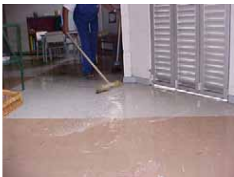
Figura 41 – Funcionária retira água da chuva que invade a sala
