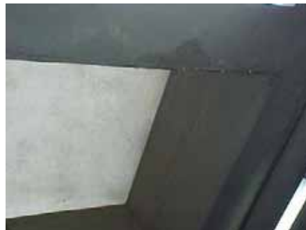
Figura 90 – Detalhe da água da chuva entrando pela abertura da clarabóia
