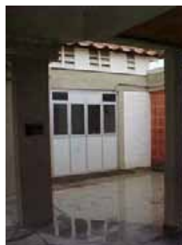
Figura 106 – Detalhe do piso molhado
