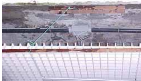
Figura 35 – Clarabóia com revestimento removido
