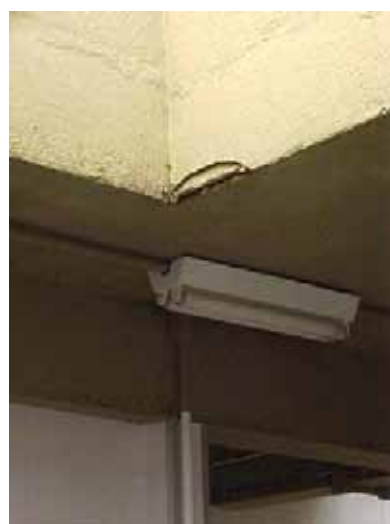
Figura 87 – Detalhe do estado de conservação da clarabóia
