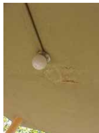
Figura 66 – Detalhe das goteiras na entrada da creche
