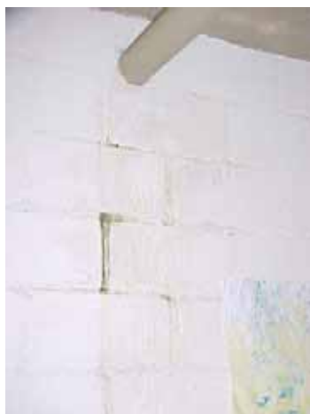
Figura 33 – Parede com infiltração
