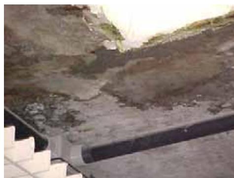
Figura 36 – Laje do banheiro com infiltrações
