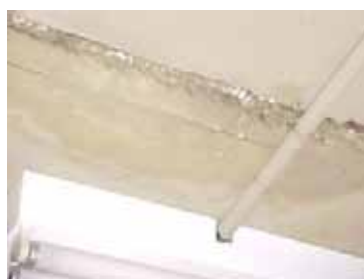
Figura 92 – Presença de umidade na laje
