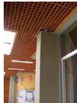
Figura 61 – Desprendimento de material
