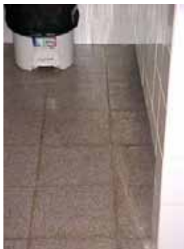
Figura 44 – Piso do banheiro molhado pela chuva
