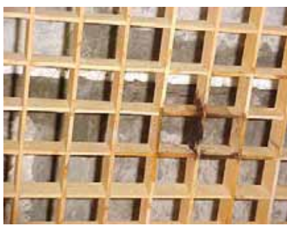
Figura 60 – Forro danificado pelas infiltrações
