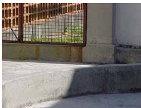
Figura 104 – Porta com sinais de ferrugem
