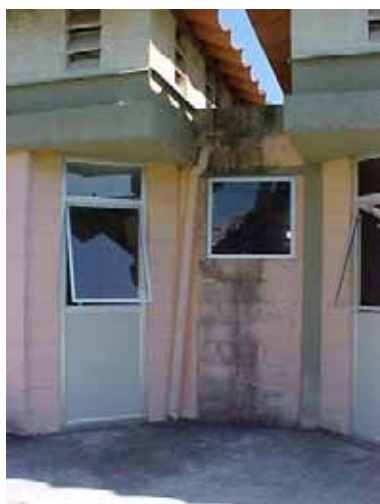
Figura 114 – Detalhe das infiltrações na fachada
