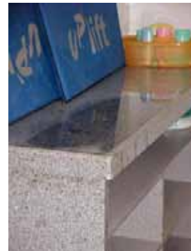
Figura 45 – Bancada do banheiro molhada pela chuva
