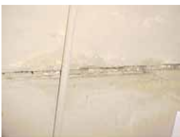
Figura 91 – Presença de umidade na laje
