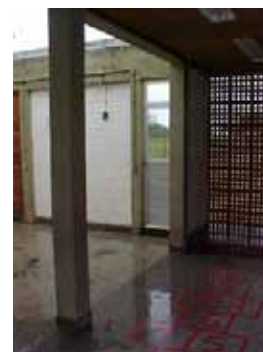
Figura 107 – Detalhe do piso molhado
