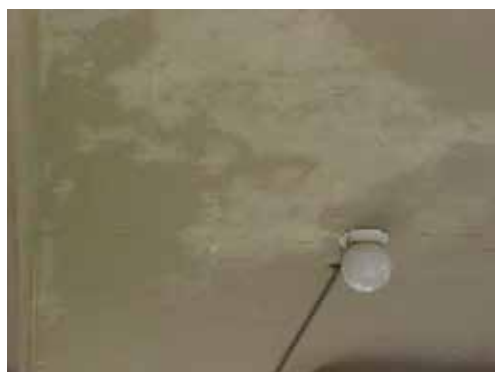
Figura 103 – Manchas no teto
