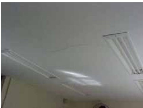
Figura 84 – Detalhe do gesso trincado
