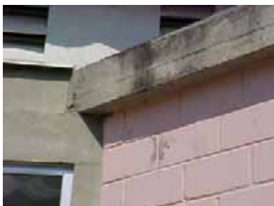
Figura 100 – Manchas nas paredes
