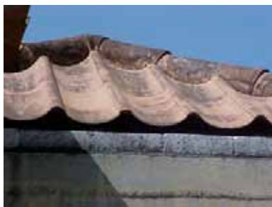
Figura 101 – Manchas nas paredes
