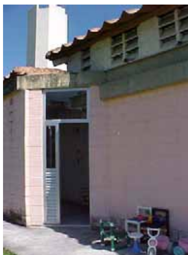
Figura 115 – Sinais de manchas na fachada.
