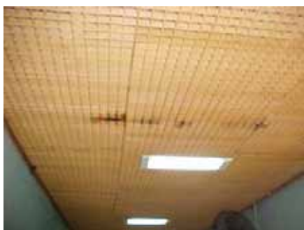
Figura 59 – Infiltrações na clarabóia
