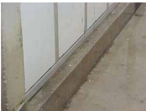
Figura 76 – Infiltração de água pela fresta na divisória
