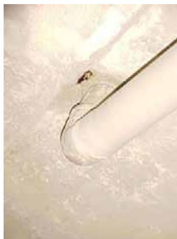
Figura 34 – Laje com sinais de infiltração de águas pluviais
