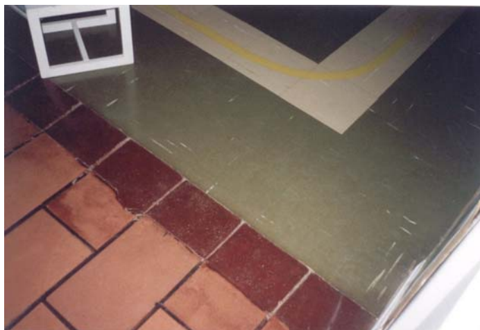
Figura 33 – Detalhe despadronização pisos (Sala de Atividades Jardim)
