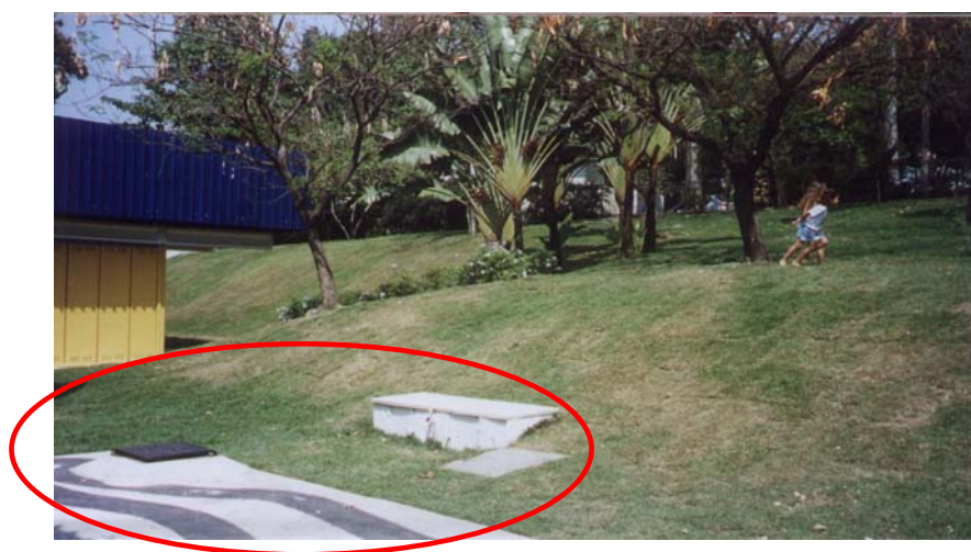
Figura 7 - Vista da cisterna e visitas representando um risco para as crianças
