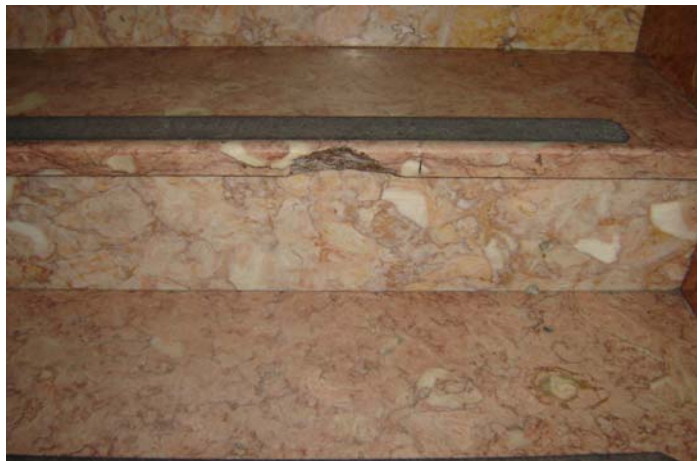
Foto 14: Vista do degrau que precisa de reparos
