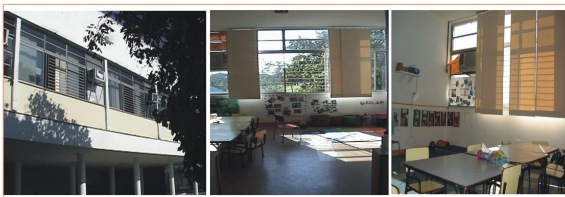
Figura 7 – a. Fachada onde estão orientadas as salas de aula (exposição direta a radiação solar); b. Radiação solar direta no interior da sala; c. Painéis deslizantes utilizados para bloquear a entrada da radiação solar.
