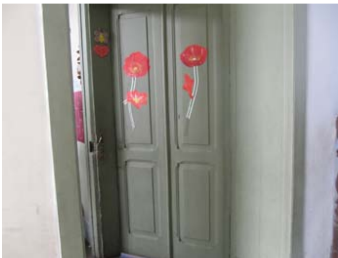
05- Porta de acesso a refeitório fechada.
