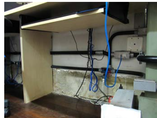
04- Instalações aparentes danificam rodapé original
