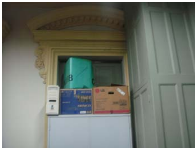
02- Porta de comunicação com sala adjacente obstruída por armário de aço.
