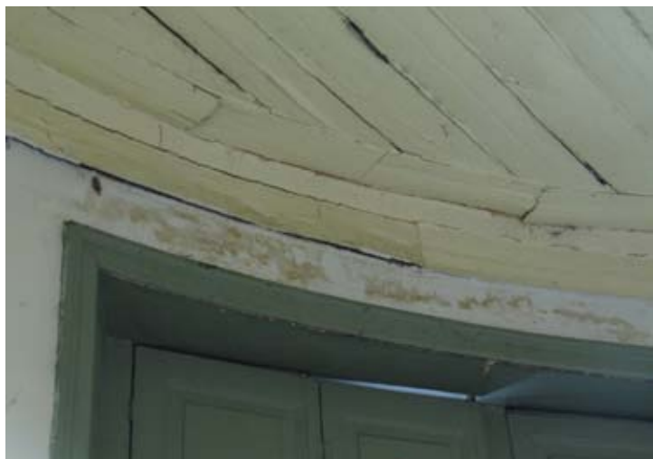
03- Infiltrações no forro e parede
