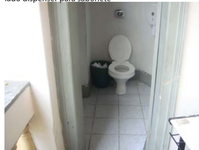
06- Vista frontal do vaso. Pintura da parede e rodapé em mal estado e válvula de descarga danificada
