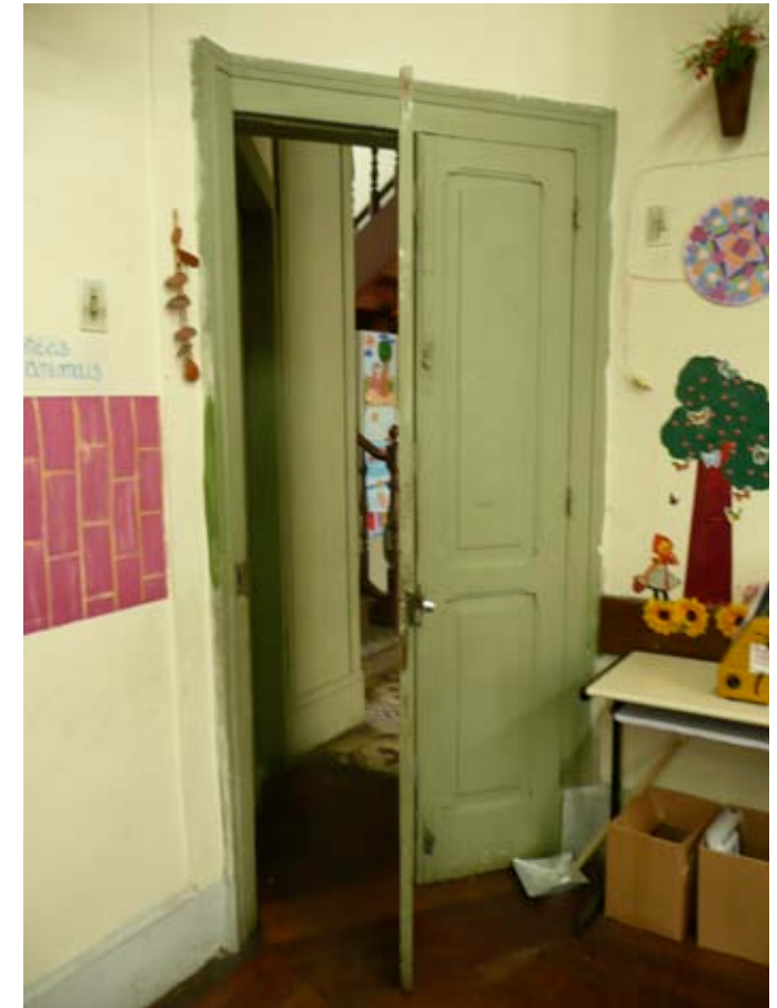
03- Devido a organização interna, porta abre parcialmente
