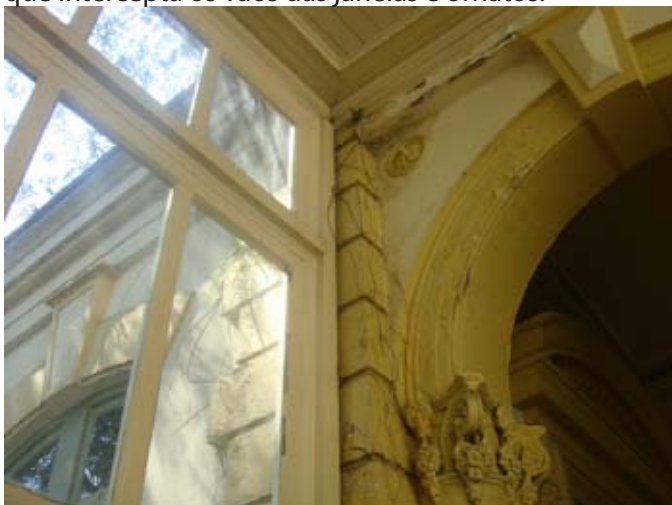
04- Detalhe da conservação da fachada: madeiras apodrecidas, pintura com infiltração e plantas enraizadas nas paredes.
