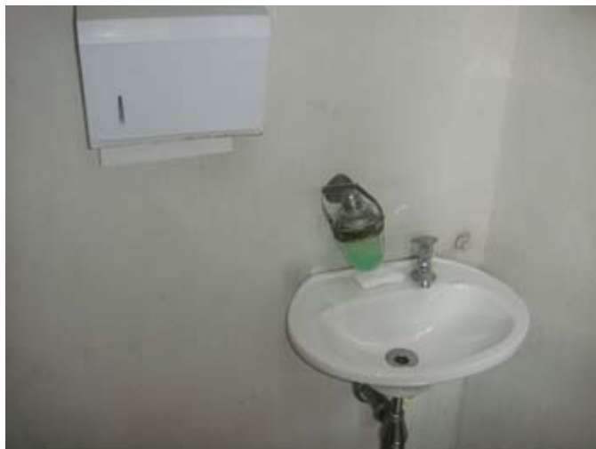
02- Parede da pia sem revestimento, pintura em mal estado de conservação.
