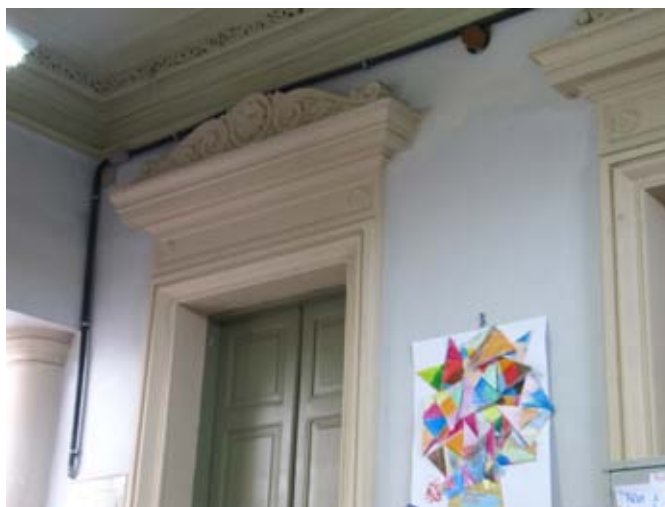
02- Instalações aparentes próximas ao forro
