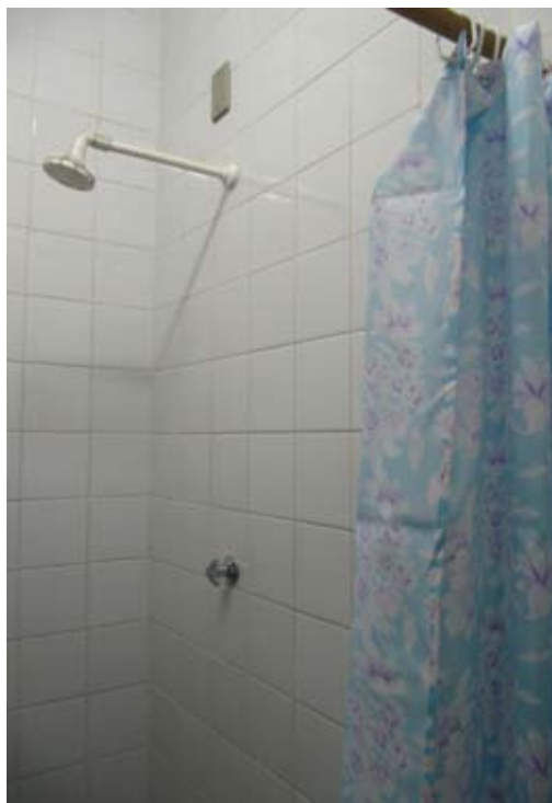
01- Chuveiro para uso dos funcionários
