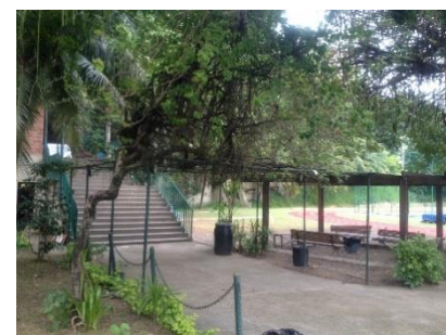
(c) Declive na escada de acesso à escola
